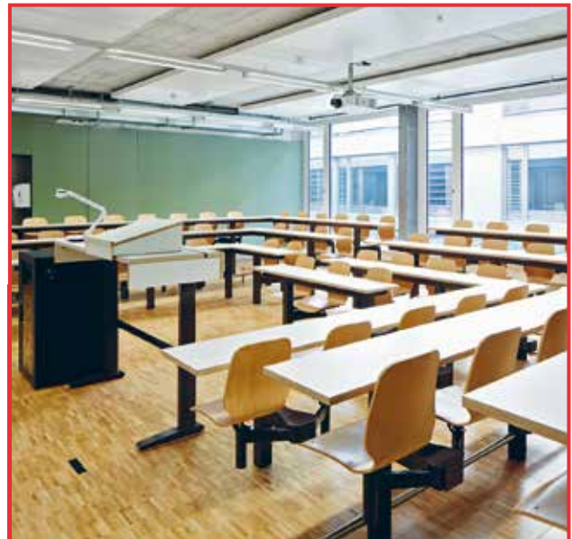
Seminarraum mit thermoaktiven Deckenmodulen.
