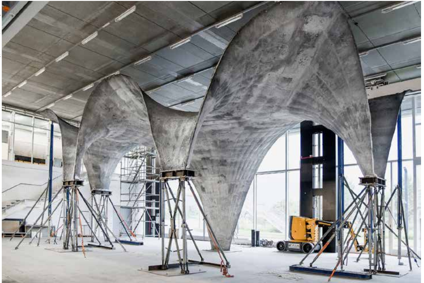
ETH-Wissenschaftler bauten auf dem Campus Höggerberg den Prototypen des Leichtbau-Betondachs für das Forschungsgebäude Nest.
